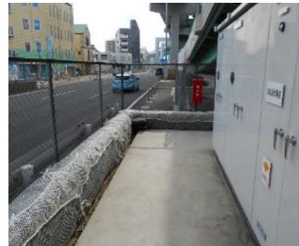
図31 変電塔の津波浸水対策状況 土嚢による対策 (令和2年3月末)
