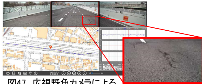
図47 広視野角カメラによる路面変状の拡大写真 取得データ
