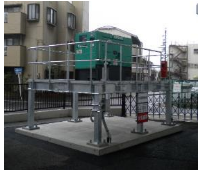
図30 BCP用電源整備事例 (平成27年度)
