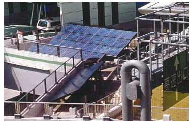
太陽光発電設備（黒川出入口）
