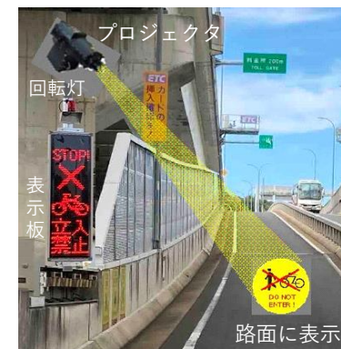
警告システム事例
