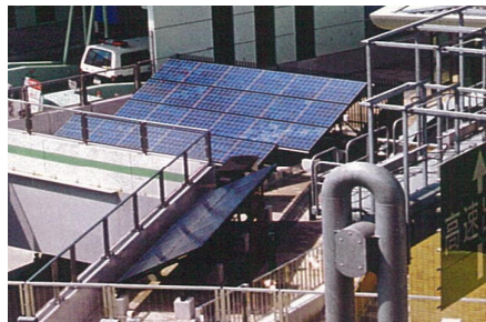
太陽光発電設備（黒川出入口）
