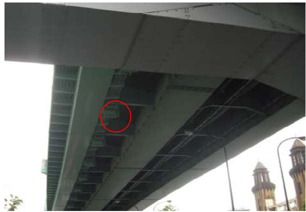
(図-2) コンクリート片が落下した箇所
