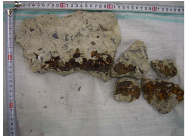
(図-4) 落下したコンクリート片
