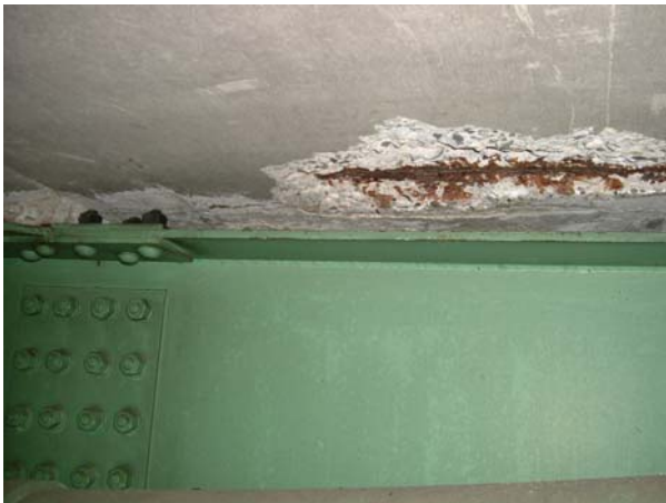
(図-3) コンクリート片が落下した箇所
