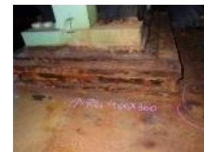
支承部の損傷状況
