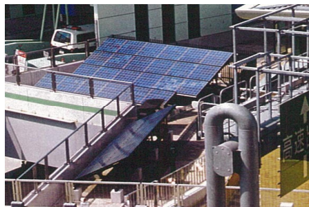
太陽光発電設備（黒川出入口）
