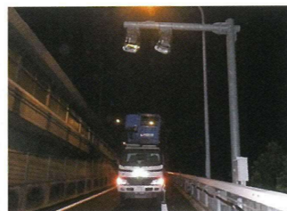
通信設備の点検
