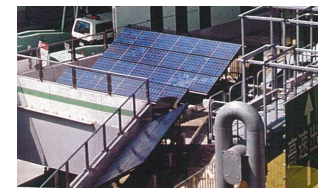
太陽光発電設備(黒川出入口)
