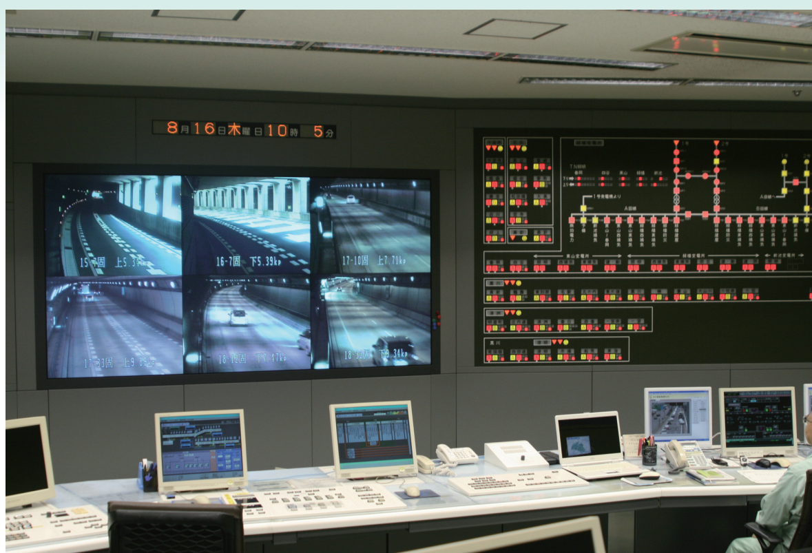
施設管制室（緑橋換気所）
