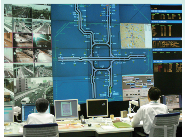
交通管制室（黒川ビル）
