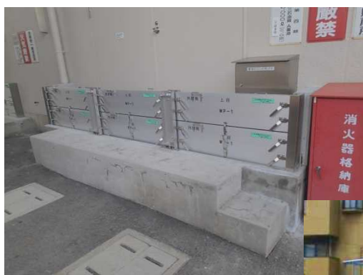
受変電施設の止水板設置例
