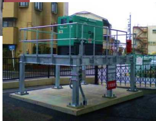
事務所非常用発電機の設置例
