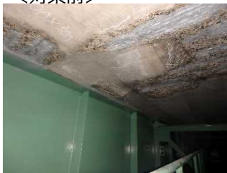
床版下面の損傷状況
