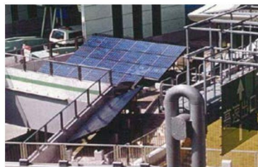
太陽光発電設備（黒川出入口）
