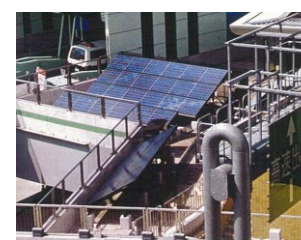
太陽光発電設備 (黒川出入口)
