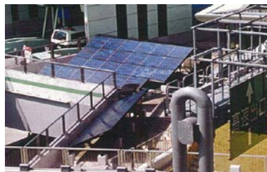
太陽光発電設備（黒川出入口）
